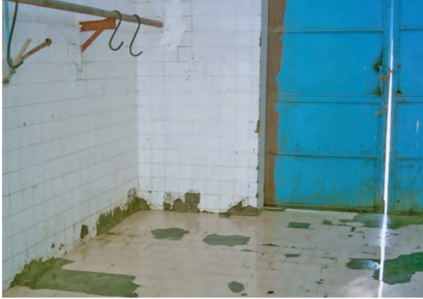
الشكل 2: أرضيات وجدران متشققة ومتآكلة بصالة الذبح بإحدى السلخانات التي شملتها الدراسة.
